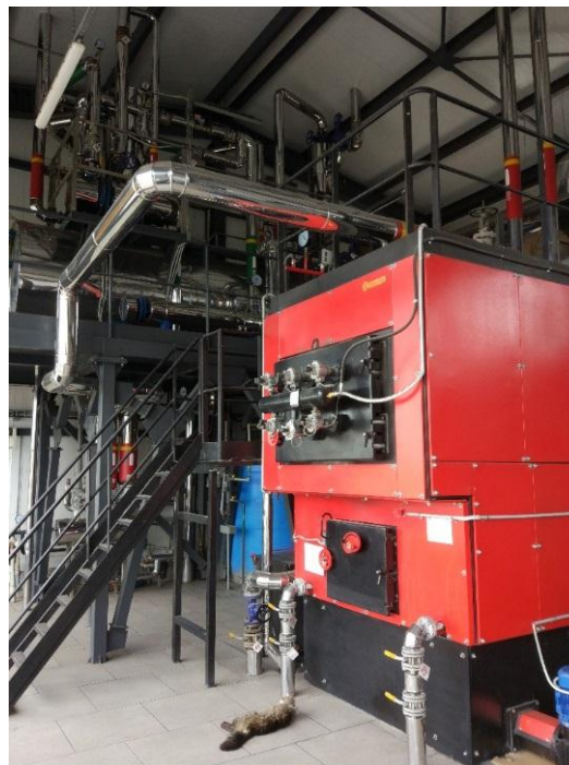
Figure 2.1 La caldaia a vapore a biomasse della ITC Shabo. Fonte: SECB
