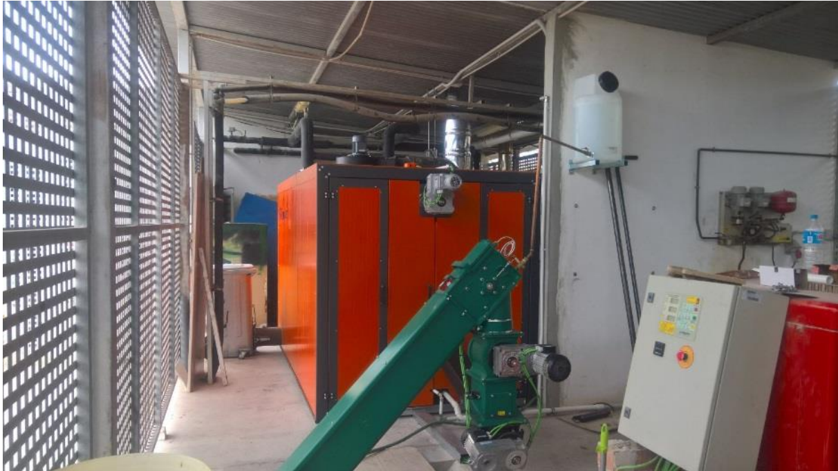
Figura 16: Calefacción de una piscina en Calpe (España) con PARP. Modelo de la caldera RHK AK300 de HEIZOMAT
