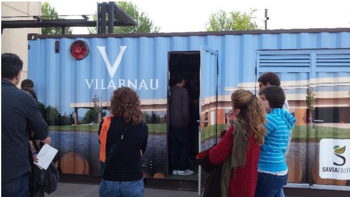
Figura 17: Contenedor con una caldera HERZ Firematic (130 kW) instalada en las Cavas Vilarnau para suministrar calor
